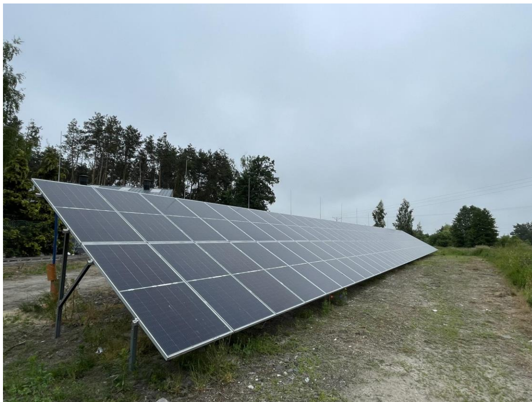
Zdjęcie nr 22. Instalacja fotowoltaiczna na terenie oczyszczalni ścieków w Wisznicach
