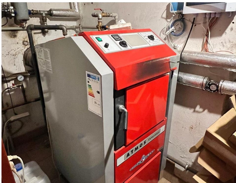
Zdjęcie nr 2. Kocioł zgasowujący drewno – posesja prywatna
