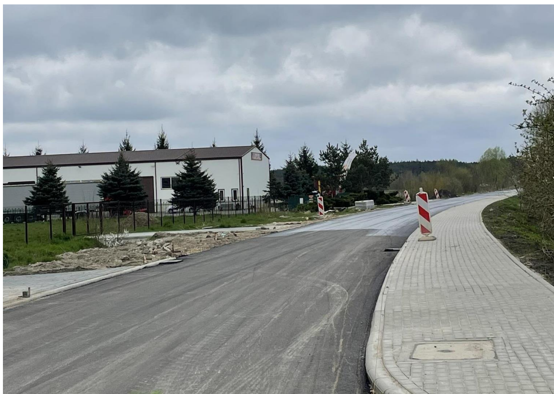
Zdjęcie nr 19. Przebudowa drogi gminnej nr 101246L - ul. Zamkowej w miejscowości Horodyszczce
